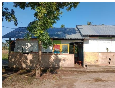
Gambar 6. Kondisi Bangunan Kelas 4,5,6 SDN 2 Padak Guar Sumber: Dokumentasi Lapangan (2025)
